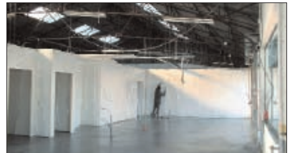
2 Une dalle de 20 cm en béton a été coulée sur toute la surface à exploiter et des panneaux sandwich ont fait le reste.
