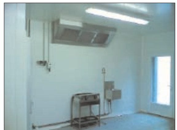
La hotte aspirante est équipée d'un extracteur
