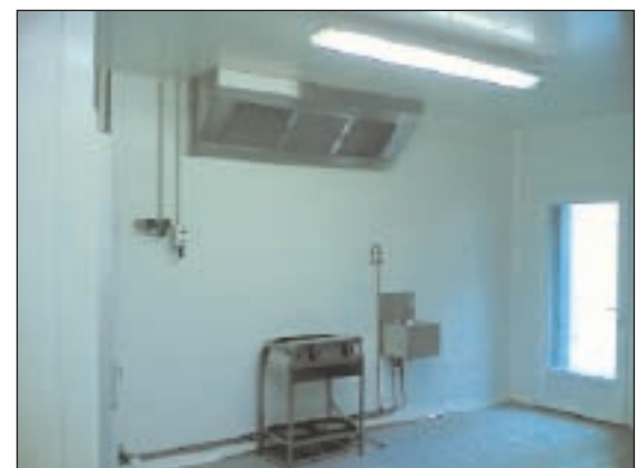
La hotte aspirante est équipée d'un extracteur
